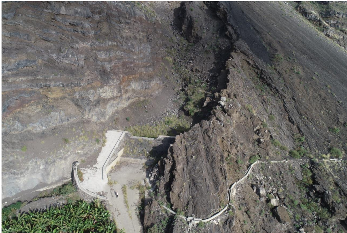
Vista aérea del encauzamiento del barranco de Los Guanches en una pista agrícola a su entrada en el Paisaje Protegido.
